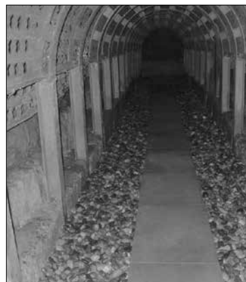
Die Quellfassung Steinmoos, die tief in den Irchel hinein gegraben wurde.
